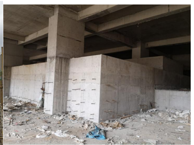
新院区门诊医技楼-1F 设备管道层
