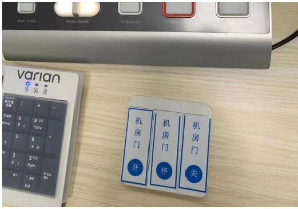
迷宫内机房门旁紧急开门按钮
