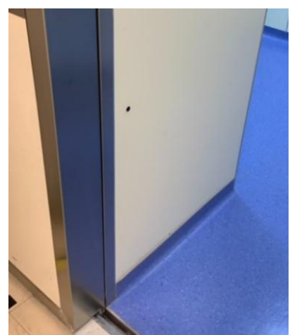
机房防护门防夹装置
